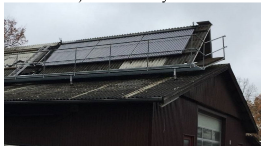
b) Solar collectors
