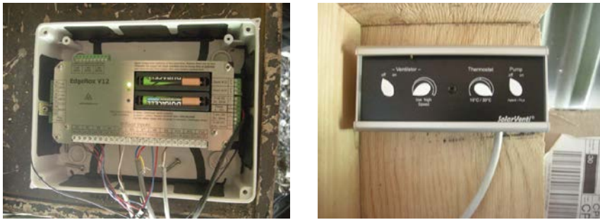
Figur 12. Datalogger type EdgeBox V12 (venstre) og kontrolboksen til luftsolfangeren SV14 fra SolarVenti A/S. Kontrolboksen får strøm fra det indbyggede PV-modul ligesom den i SV14 indbyggede ventilator.
